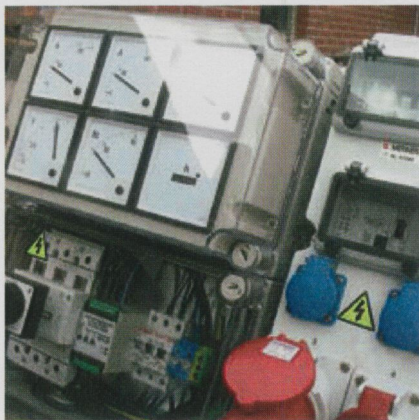
Schaltkasten eines Generators mit Generatorschalter und entsprechenden Anzeigeelementen
