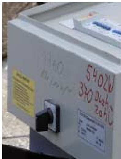
Das Schalten des Schutzleiters bei Zapfwellenaggregaten für Haus- und Feldbetrieb mit Isolationsüberwachung ist laut der VDE-Vorschrift 0100-540 nicht zulässig.
