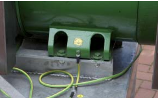
Bei ordnungsgemäßer Erdung des Generators kann im Rahmen einer Hauseinspeisung auf einen eigenen FI verzichtet werden.
