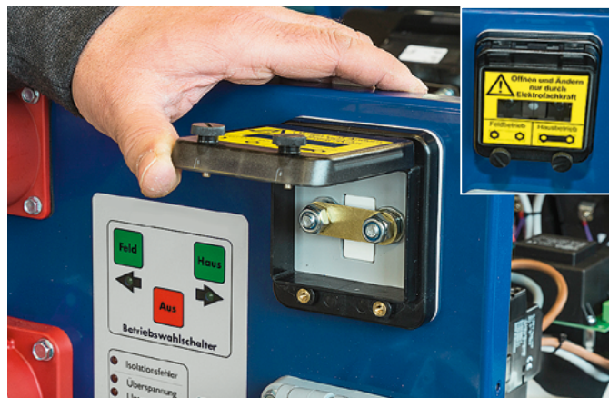
Tödlicher Stromschlag möglich: Ob Strom an der Klemme anliegt, erkennt der Landwirt als Laie nicht. (Fotos: Tovornik, Zäh)
