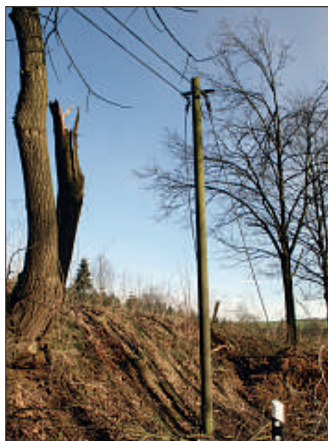
Sturmschäden an den Stromleitungen können für Tiere haltende Betriebe existenzbedrohend sein.
